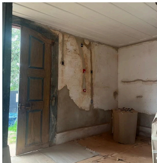
Instalações elétricas acabadas e um dos alarmes do sistema de SPCI. Autoria: Eduardo Santos Data: 07/11/2024
