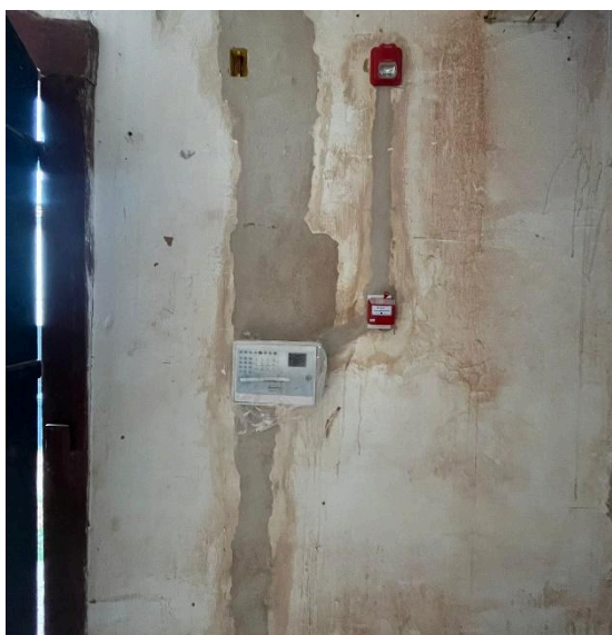
Terceiro ponto de alarme do sistema de SPCI. Autoria: Eduardo Santos Data: 07/11/2024
