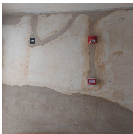
Detalhe do segundo ponto de alarme do sistema de SPCI. Autoria: Maria Leticia Ticle Data: 07/11/2024
